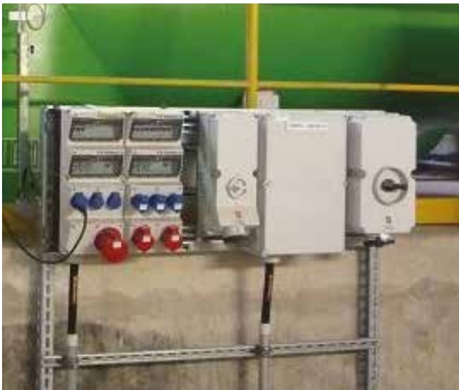
Salzgitter AG, Kraftwerk 4 , Salzgitter, Duitsland
