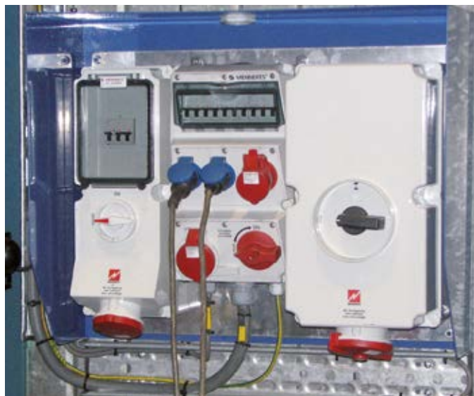
Staalproducent Arcelor Mittal , Genk – België
